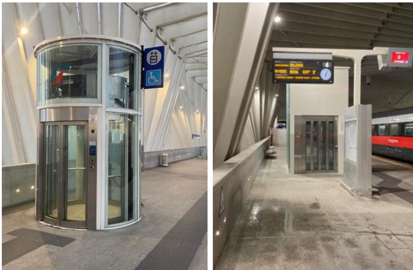
a) Uno dei due ascensori attualmente in funzione, b) uno degli ascensori a norma aggiunti e non ancora funzionanti, fotografati al livello dei binari (photo credits Augusto Giuffredi).
